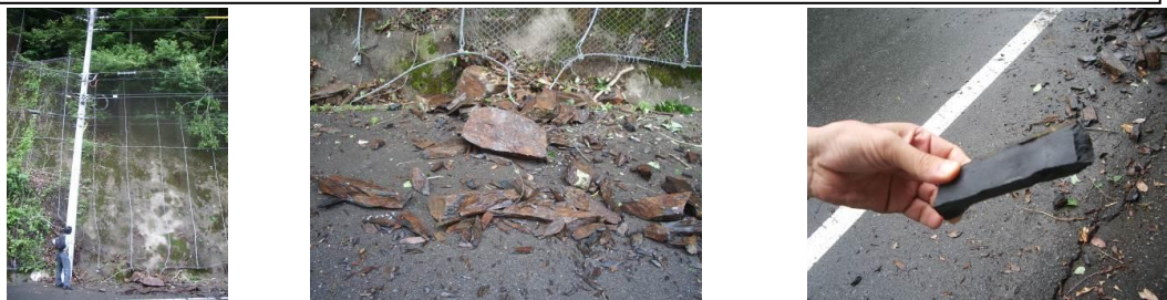
写真 現地調査当日に発生した落石
